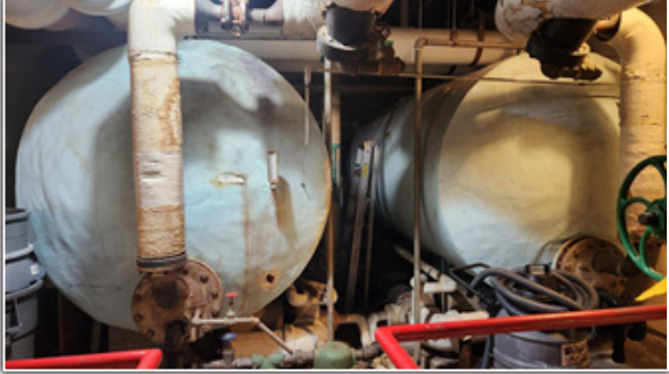
Infraestructura al final de su vida útil
